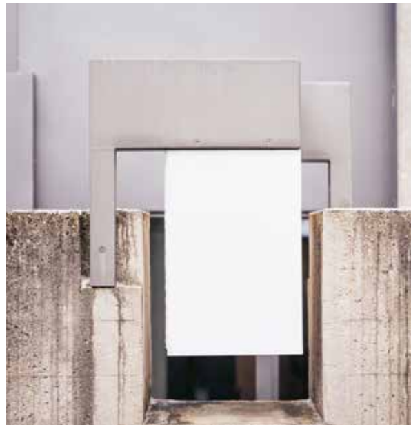
Lampe, in eine Betonbrüstung eingelassen
